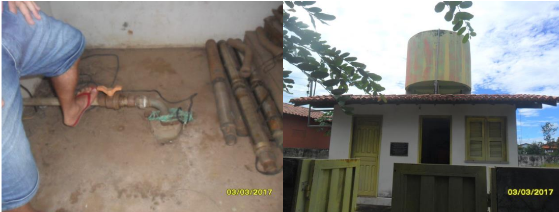
Figura 25 – Poço, abrigo do quadro de comando e reservatório
