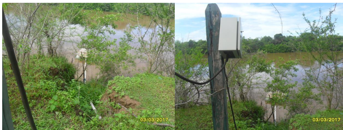
Figura 24 – Flutuante e quadro de comando da captação superficial
